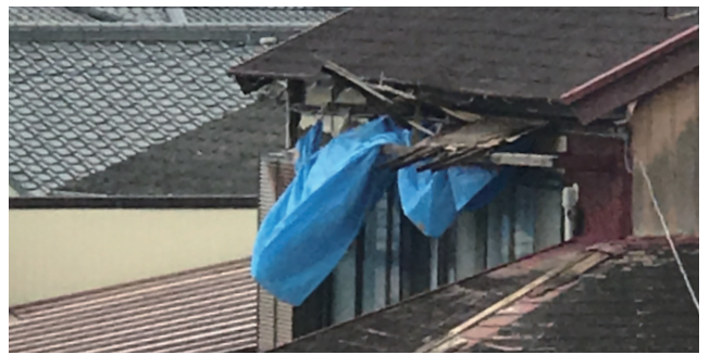
放置された空き家
