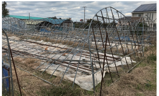
強風でなぎ倒された農業用ハウス
