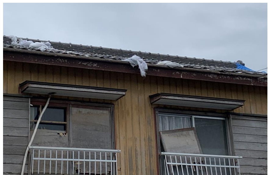
【ブルーシートがはがれ、土のう袋が破けた家】
