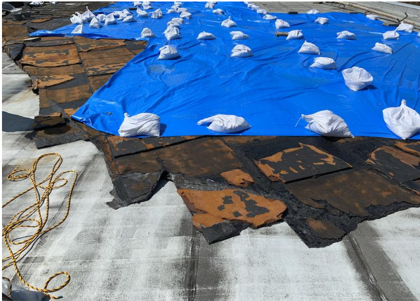
【台風15号後の三中校舎の屋上。ブルーシートで損壊場所の雨漏りをしのいでいる。9月17日撮影】
