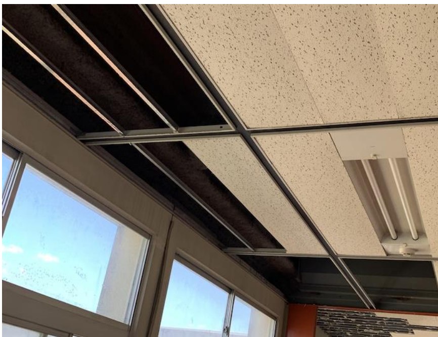
【台風15号後の三中の教室。天井が損壊したので板をはがしていた。9月17日撮影】
