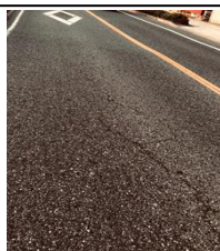
北条海岸道路陥没箇所
